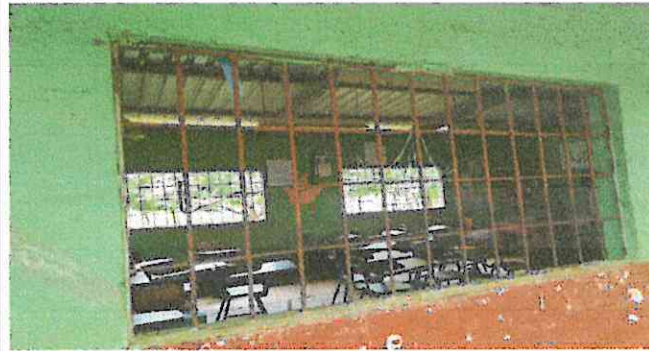
Foto 2: Balcones en mal estado.
