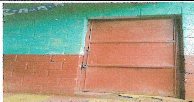
Foto 3: Puertas en mal estado, inseguras ya que la chapa no funciona.
